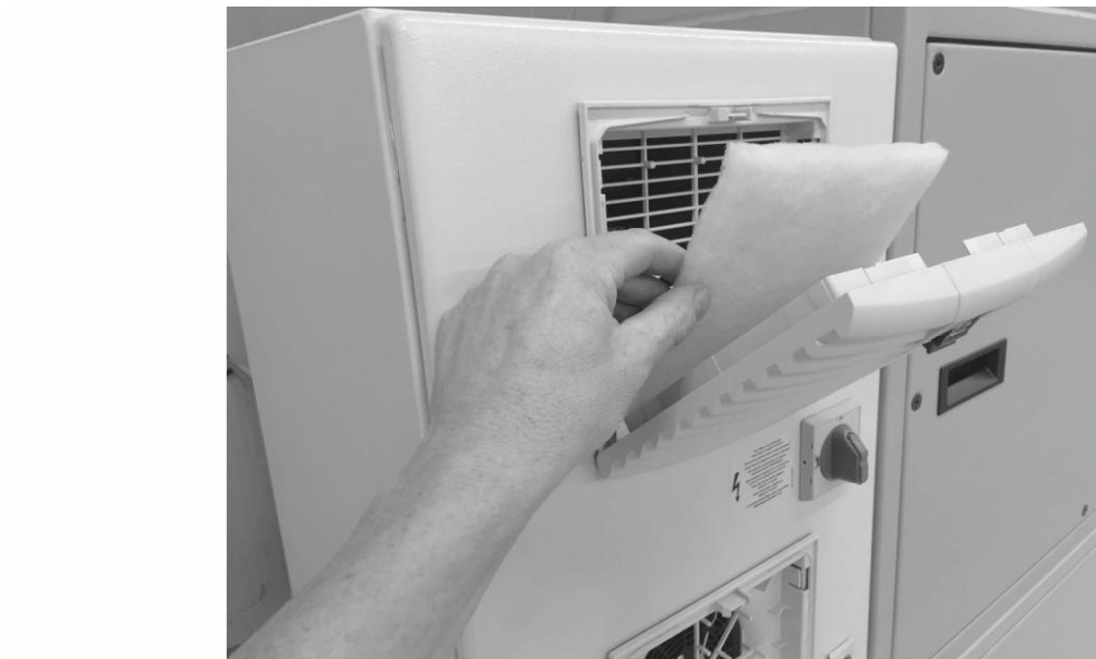
Obr. 39: Výměna filtrů skříňového rozvaděče
